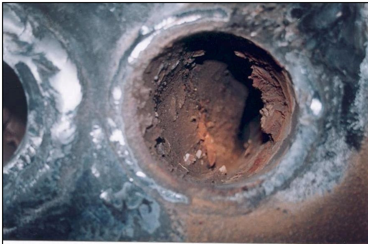
Figura N°2.3: Hollín en tubos caldera.
