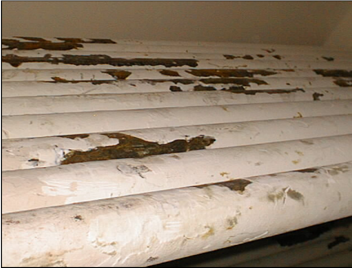
Figura N°2.4: Incrustaciones en lado agua calderas.
