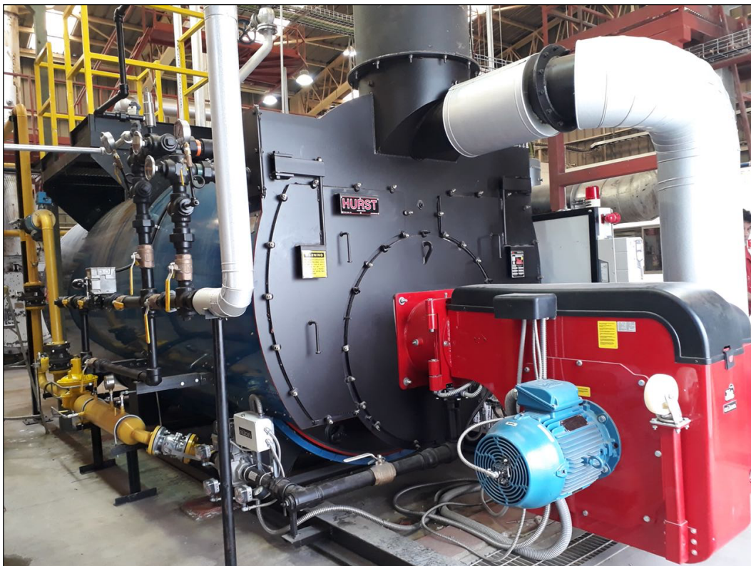
Figura N°1: Caldera/Quemador con recirculación externa de gases
