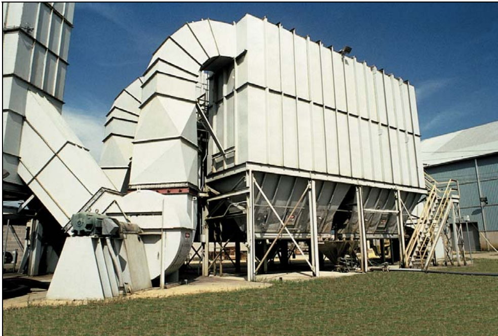
Figura N°1 Filtro de Mangas
