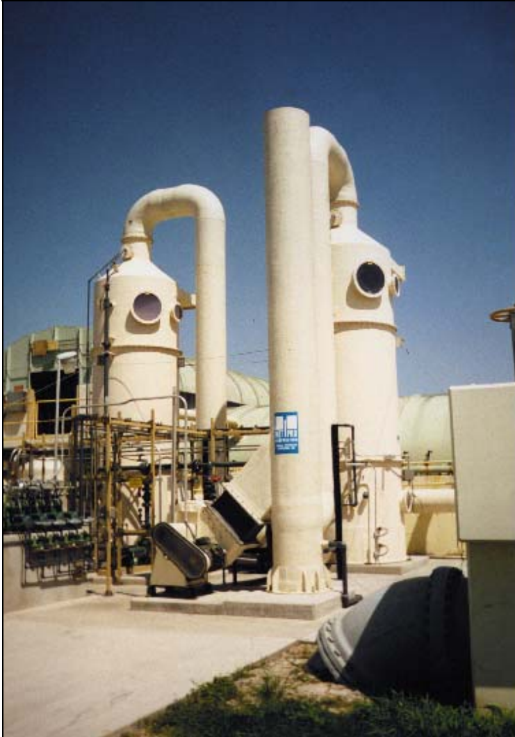
Figura N°2: Scrubber para SOx.
