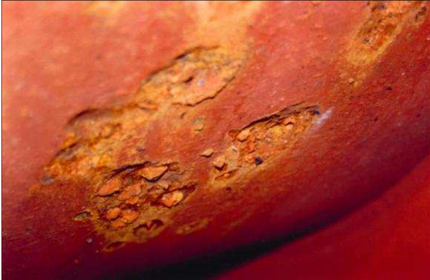
Figura n°3: Corrosión cáustica en fogón de una caldera.
