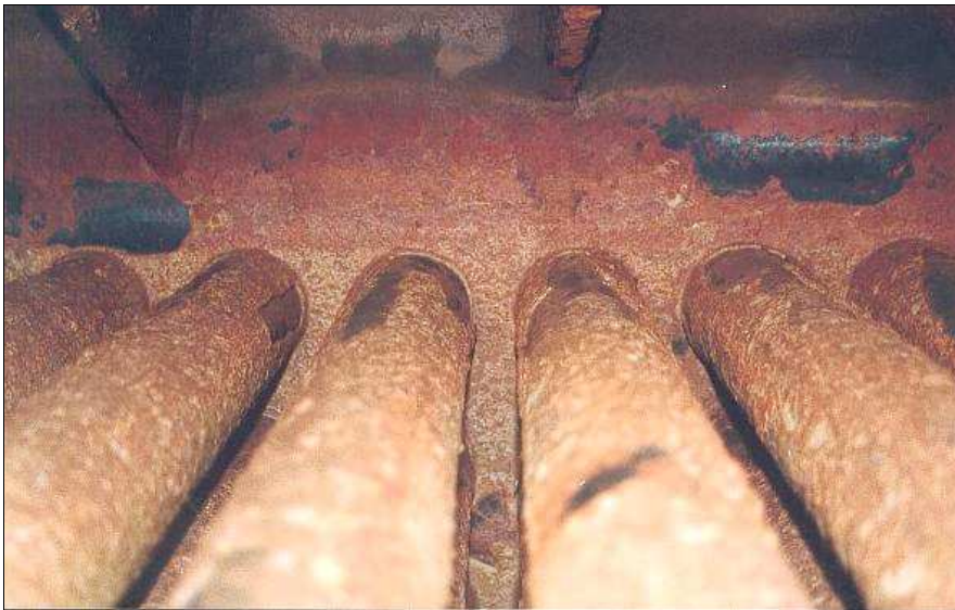
Figura nº4: Incrustaciones en tubos de humo.
