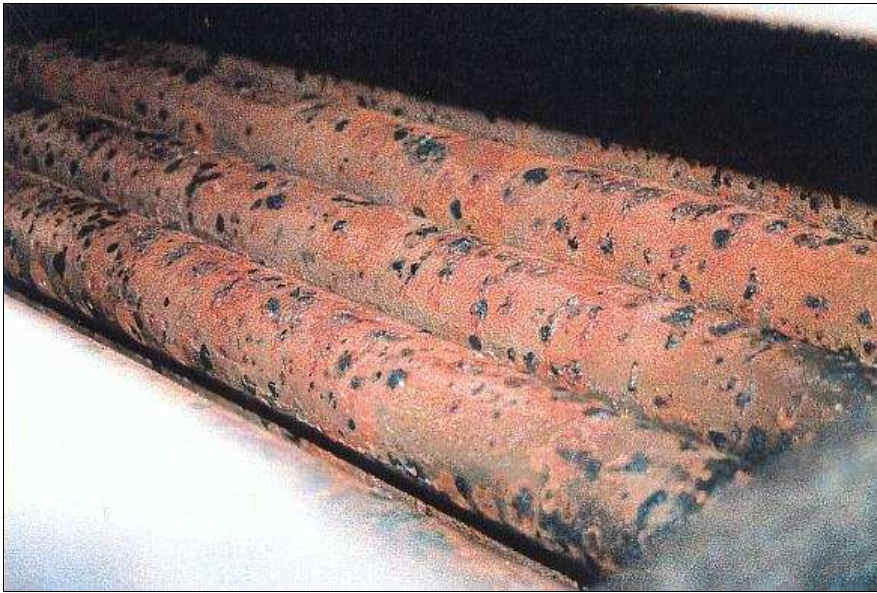
Figura n°2: Corrosión por oxígeno o “pitting”.
