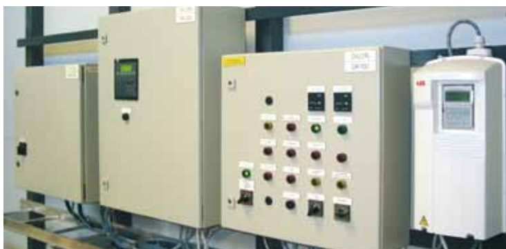
Automatización del quemador tipo All-inclusive: oxígeno (O 2 )/diferencia de presión/control en cascada.
