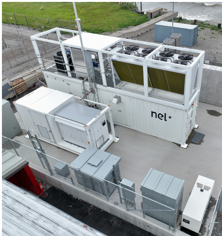
Vista general electrolizador NEL Hydrogen.
