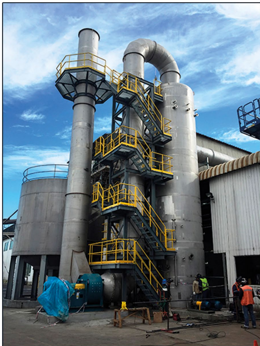
Quemador horno incineración azufre Refinería de Petróleo
