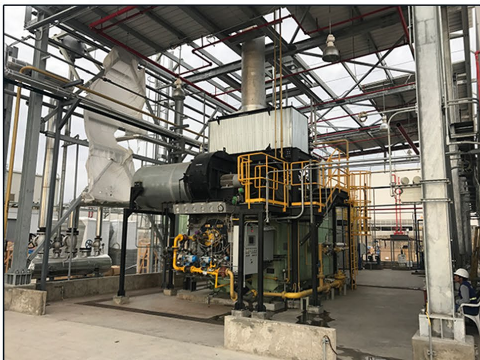
CMPC Perú – Planta Térmica
