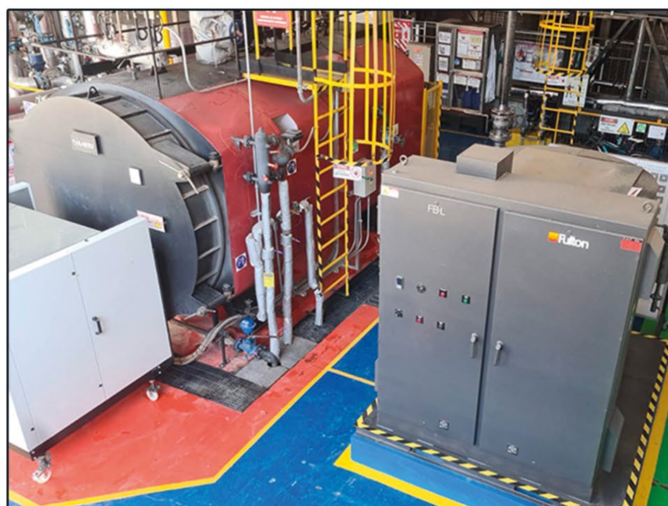
Caldera generadora de vapor eléctrica Planta Vitivinícola
