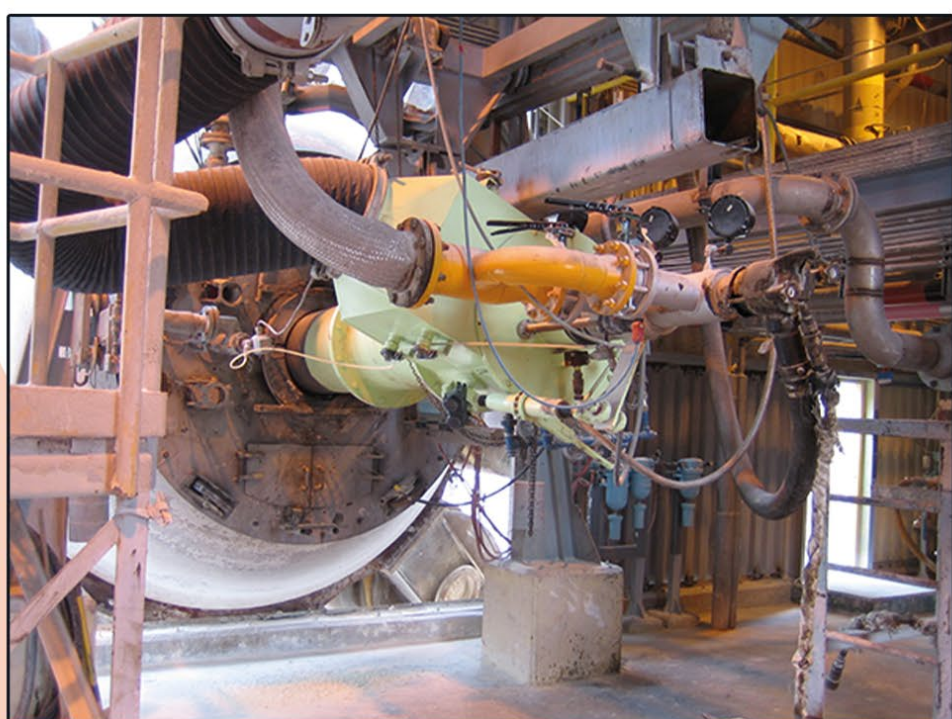
Celulosa Arauco – Quemador Horno de Cal
