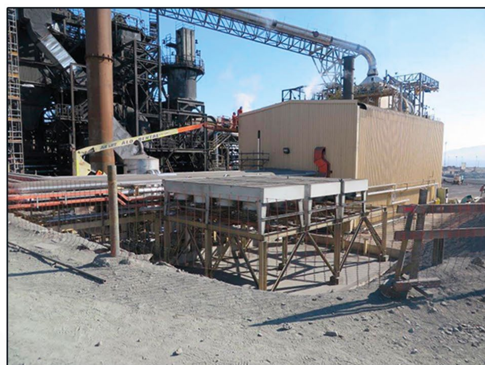
Fundición Altonorte – Planta Térmica
