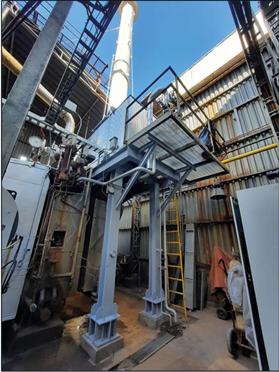
Economizador para caldera 22 ton/h Industria Pesquera
