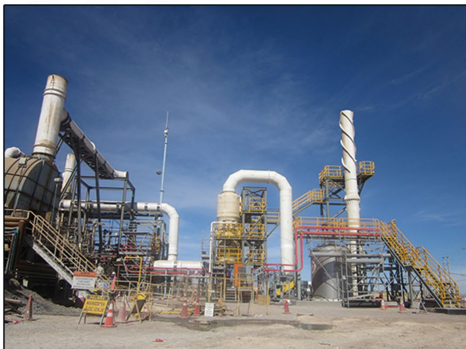
Spence – Sistema control emisiones de HCl y H 2 SO 4
