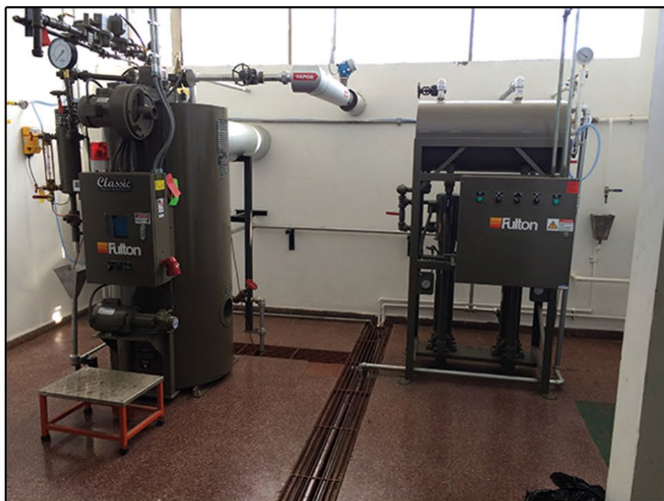
Caldera vertical y equipos auxiliares
