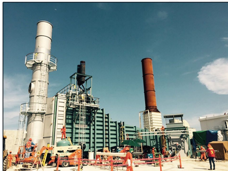
CMPC México – Caldera recuperadora
