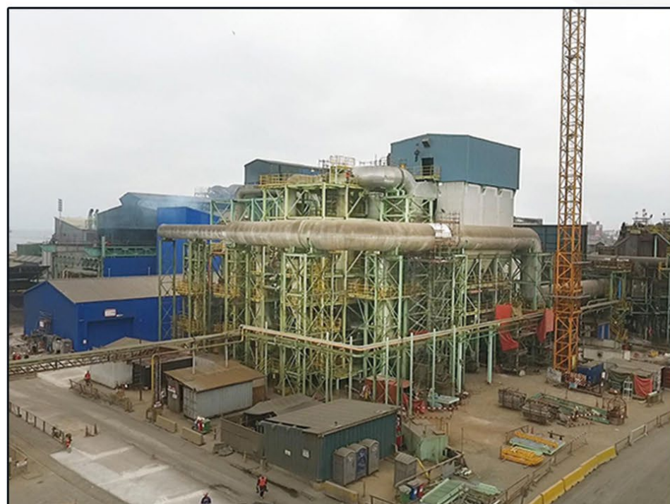
Codelco Fundición Ventanas – Filtros de mangas y scrubbers secos con SO 2 y MP en Hornos HE, CT y CPS
