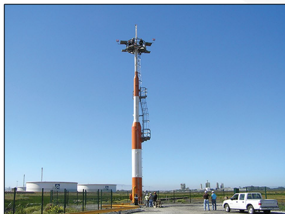
Abastible -Antorcha LPG para puerto descarga
