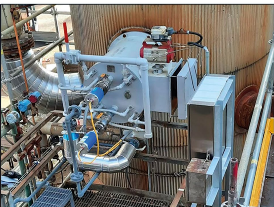
Quemador horno incinerador planta recuperadora de azufre - Refinería de petróleo
