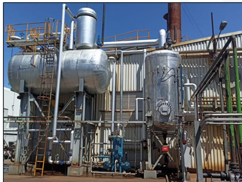
Suministro desaireador, estanque flash y recuperador calor
