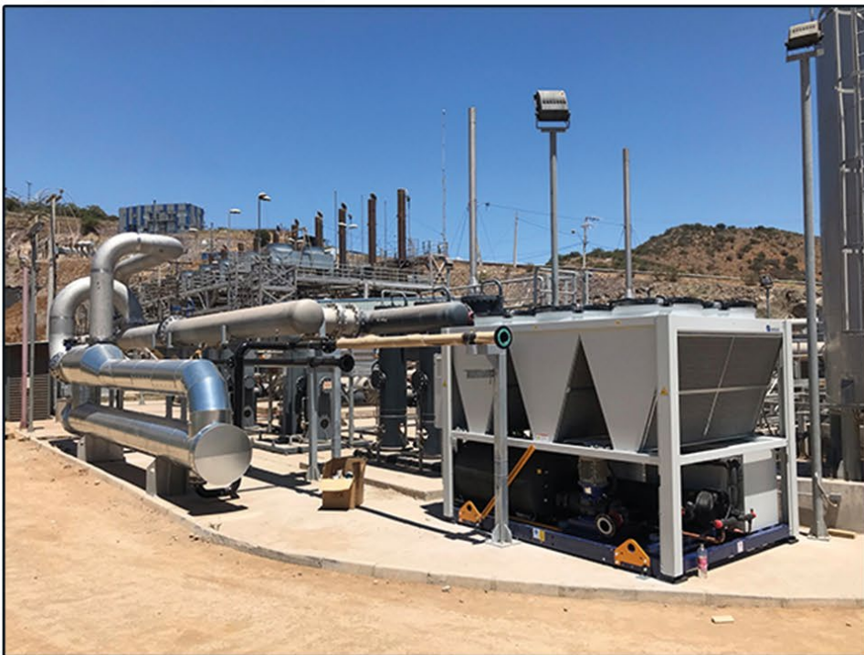
Sistema deshumidificación biogas Relleno Sanitario
