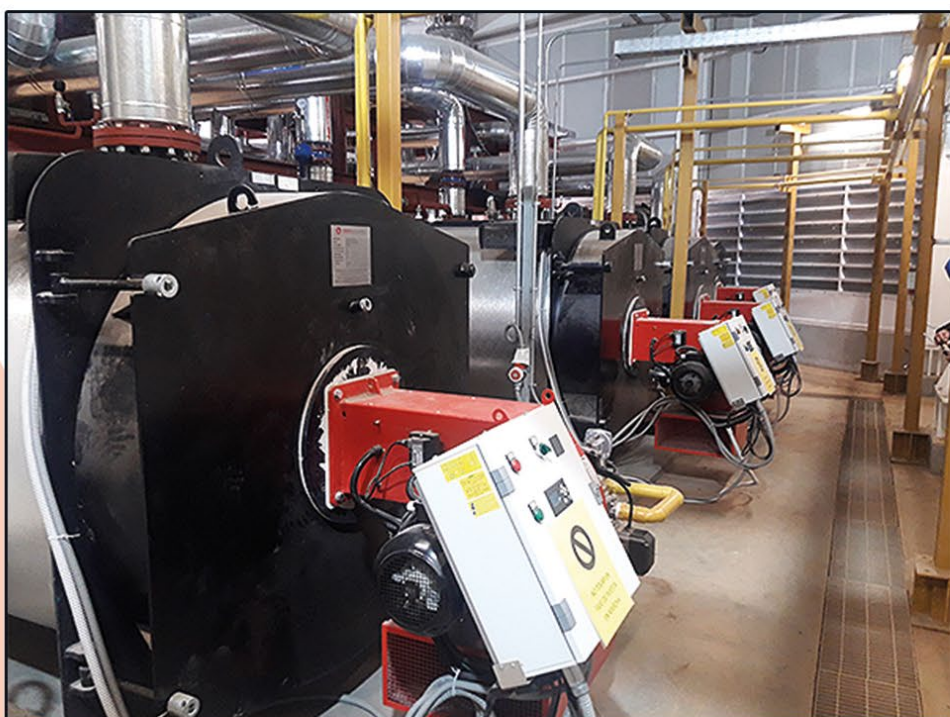
Calderas agua caliente Central térmica Aeropuerto
