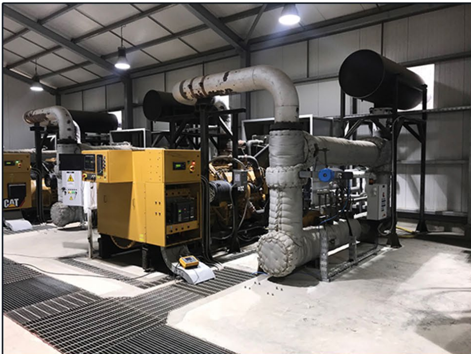
Calderas recuperadoras para motores generadores – Piscicultura
