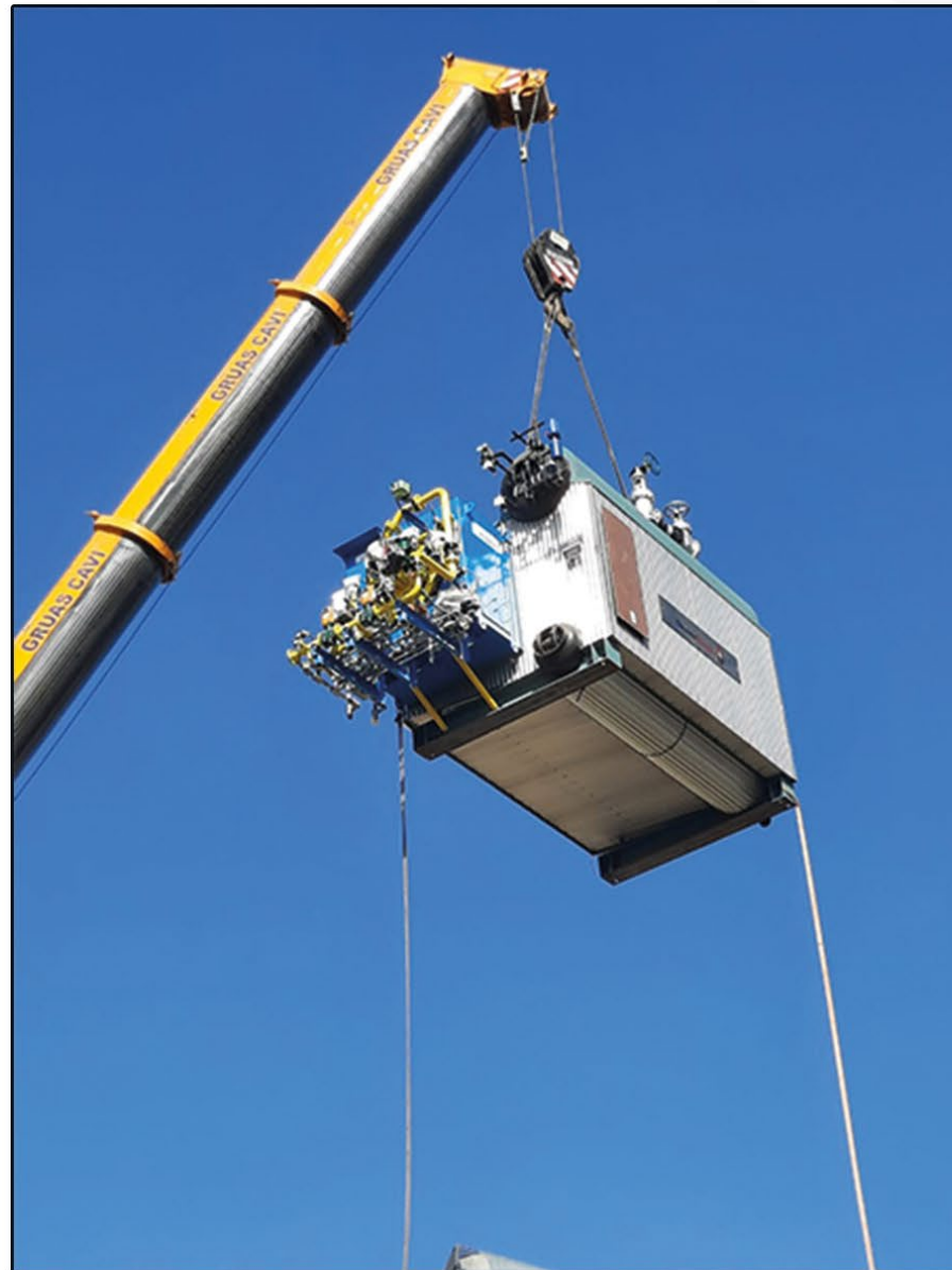
Caldera 15 ton/h - Fábrica de neumáticos
