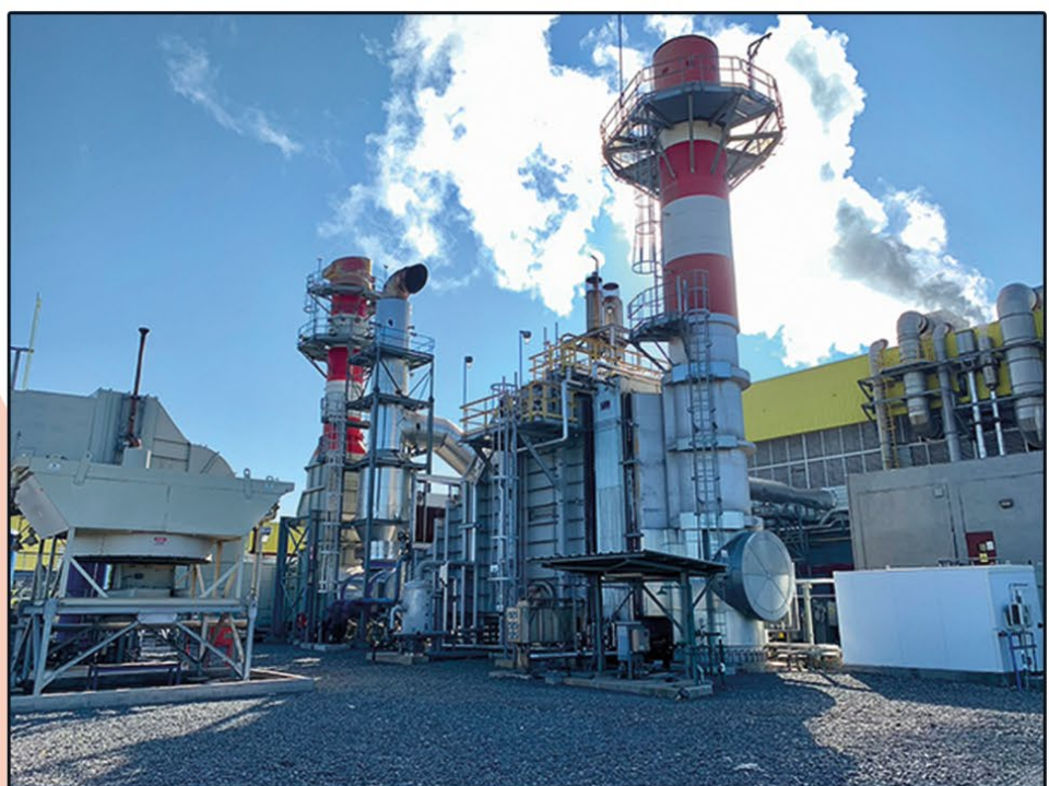
Caldera recuperadora central cogeneración Fábrica Papel Tissue
