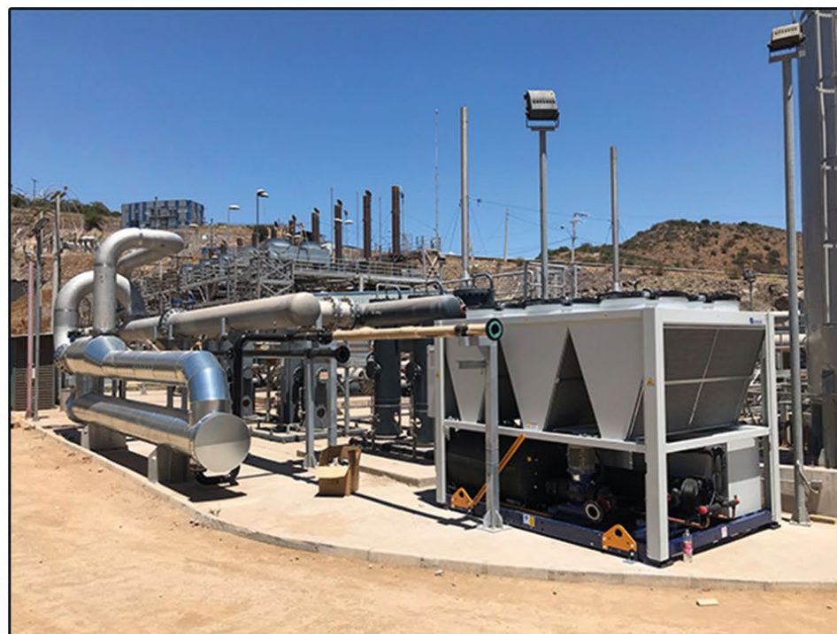
Sistema deshumidificador de Biogas Planta Generadora Relleno Sanitario
