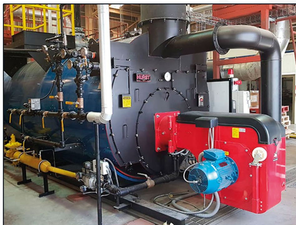
Caldera con quemador bajo NOx Planta Alimentos
