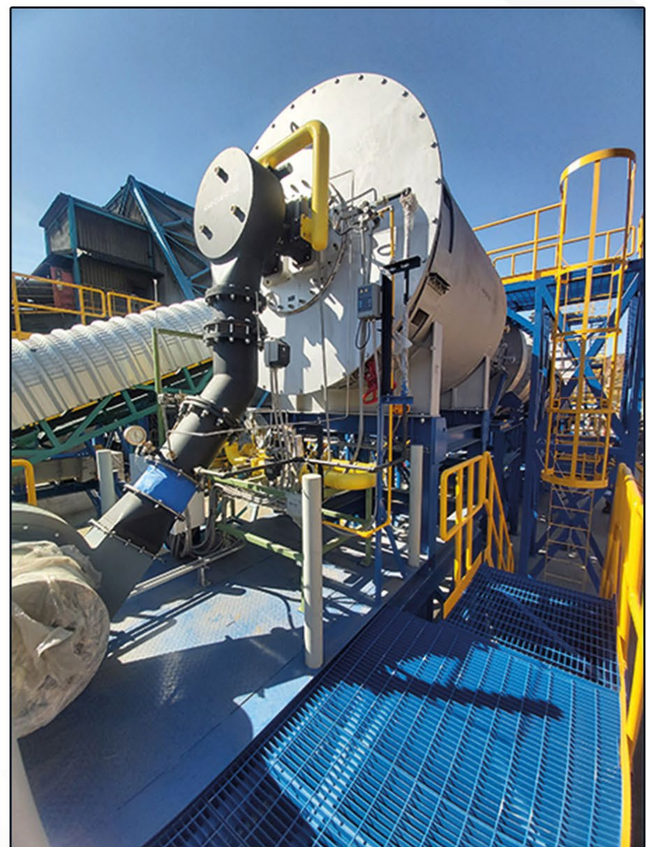
Quemador y cámara de combustión horno rotatorio – Compañía Minera
