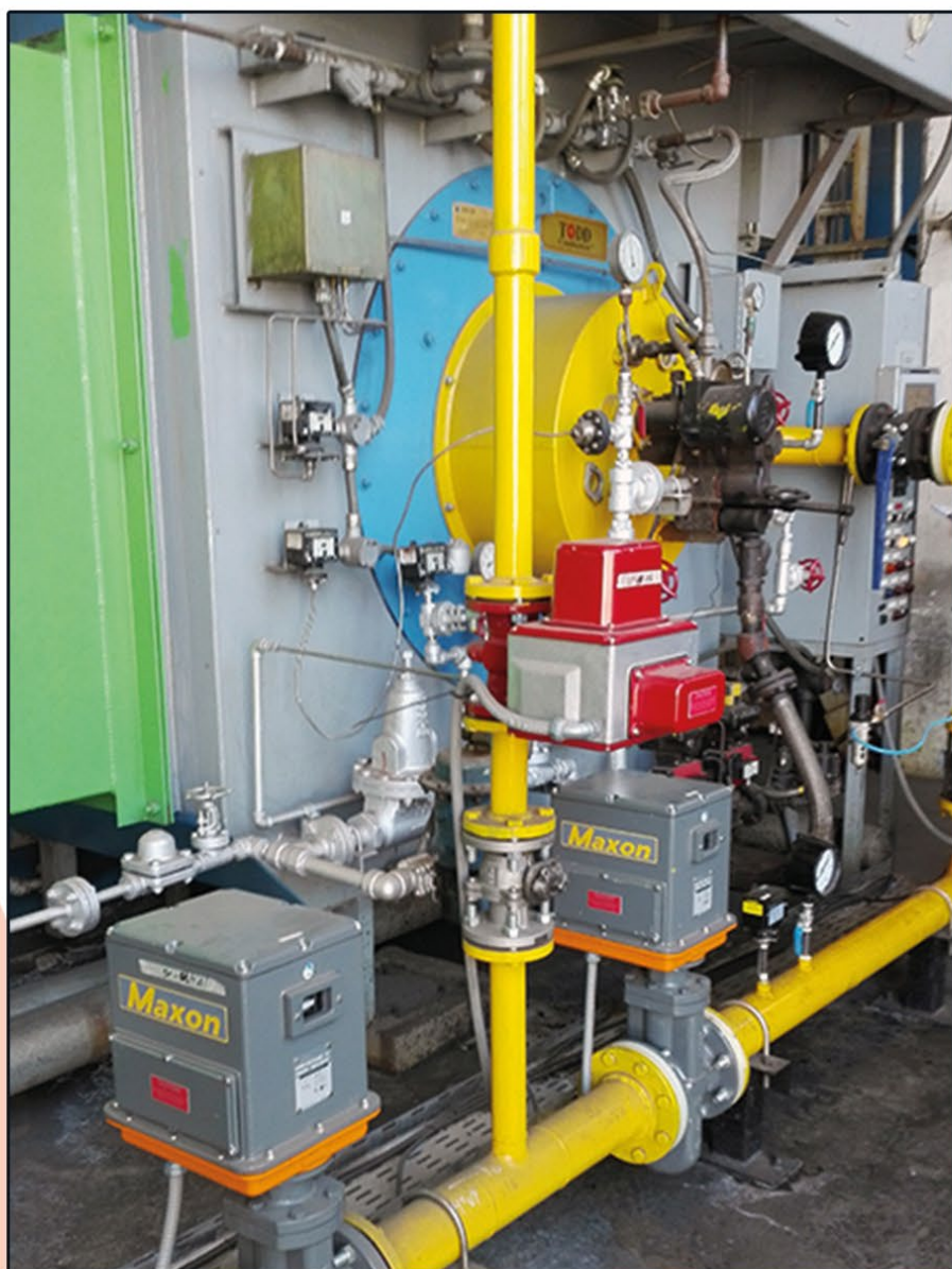
Conversión a GNL caldera 70 ton/h Planta agroindustrial
