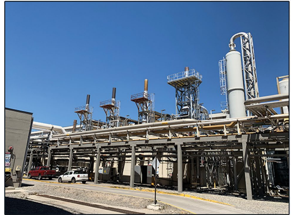
Calderas Recuperadoras Sistema de Cogeneración Planta Tratamiento de Agua
