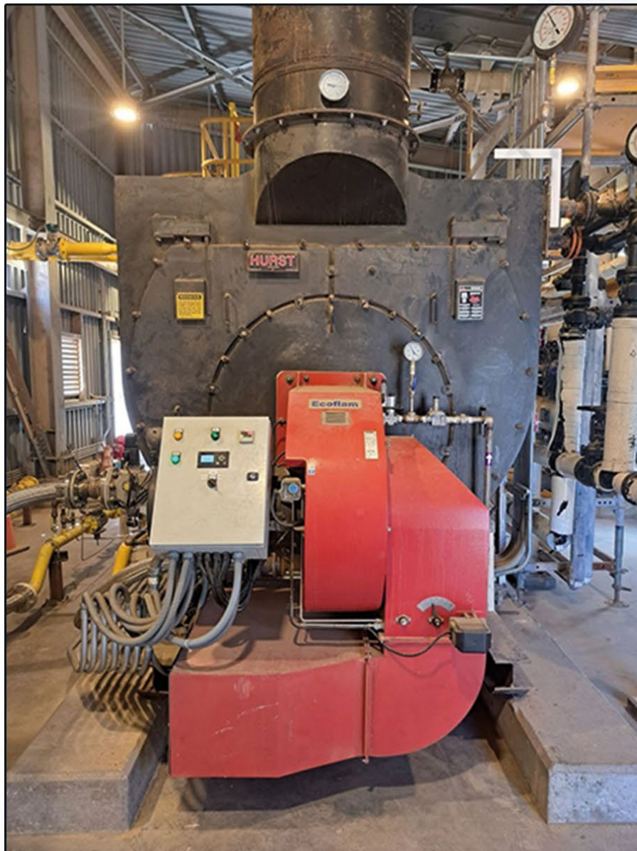
Caldera planta productora de Litio
