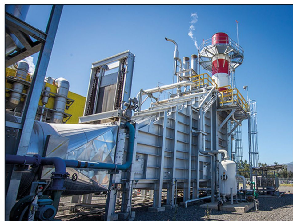
CMPC – Caldera recuperadora
